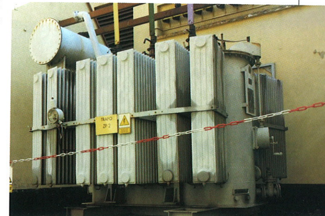
Transformator ZP-2 na podstacji Katowice Ligota
